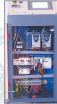
Elektrik panosu Control box
